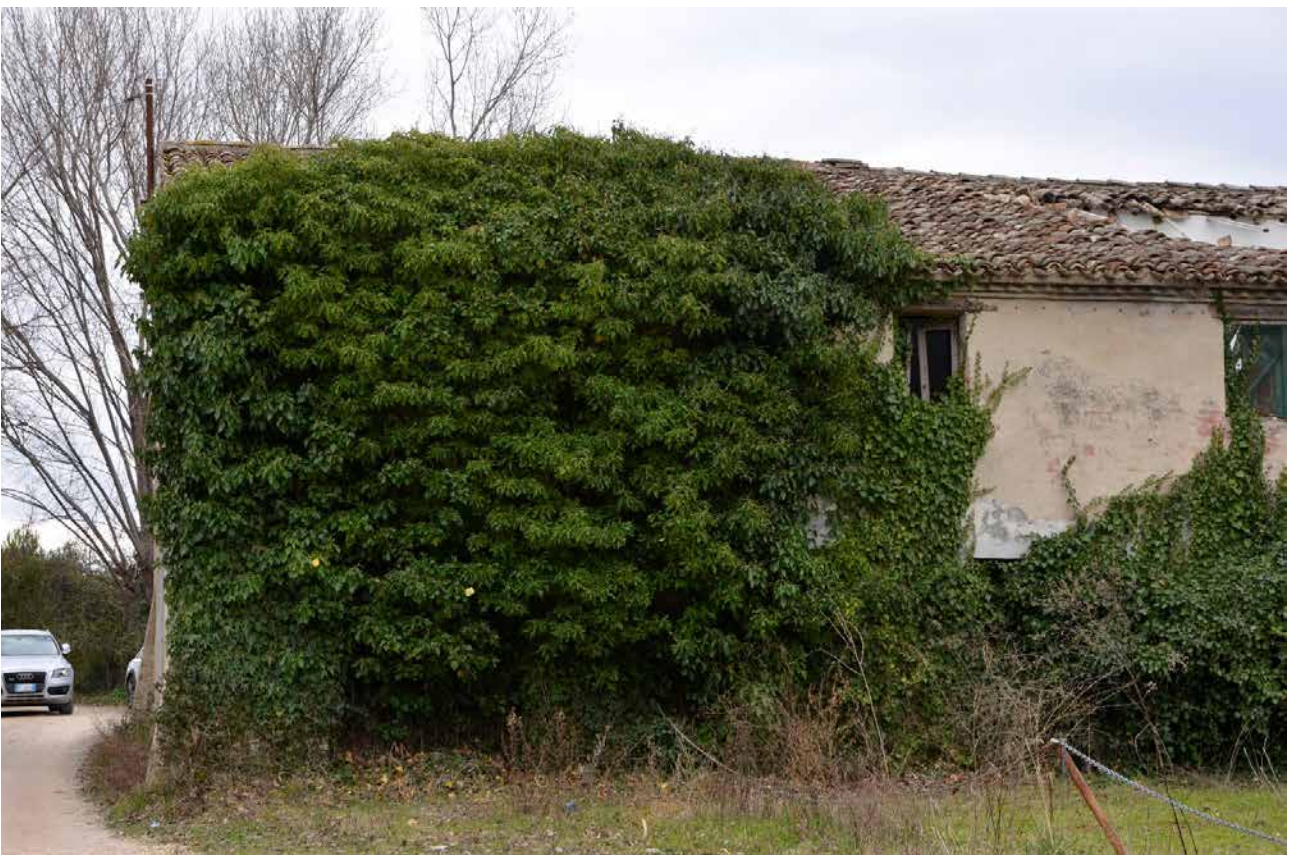
Prospetto Nord-Ovest - Vista della vegetazione infestante e del parziale crollo della copertura
